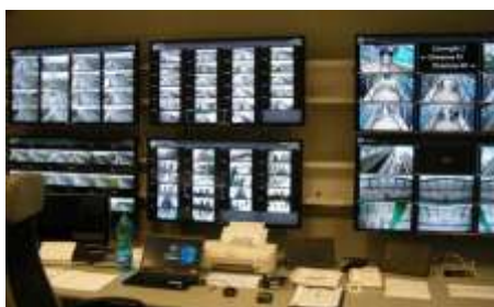
FIGURA 21 | Esempio di sala controllo di APM urbano a fune (tra circa 1'000 ed 8'000 persone/ora per direzione), simile, in piccolo, a quella delle metropolitane automatiche (tra circa 9000 e 25'000 persone/ora per direzione)
